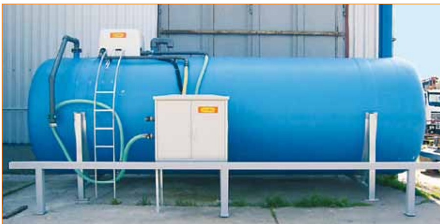
Komplett installierte Feuchtsalzanlage inkl. Pumpeneinheit
